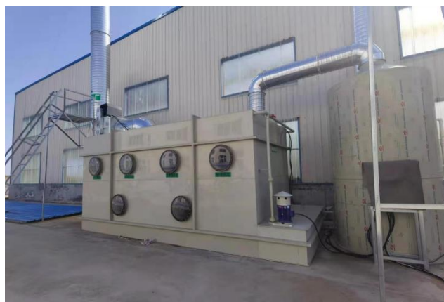
“喷淋塔+生物滤池装置”
