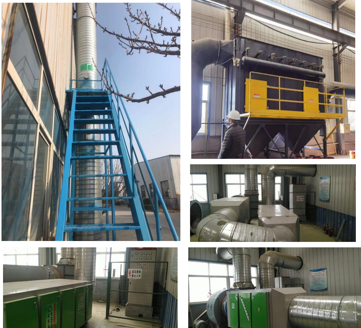
图3-1 废气处理设施
