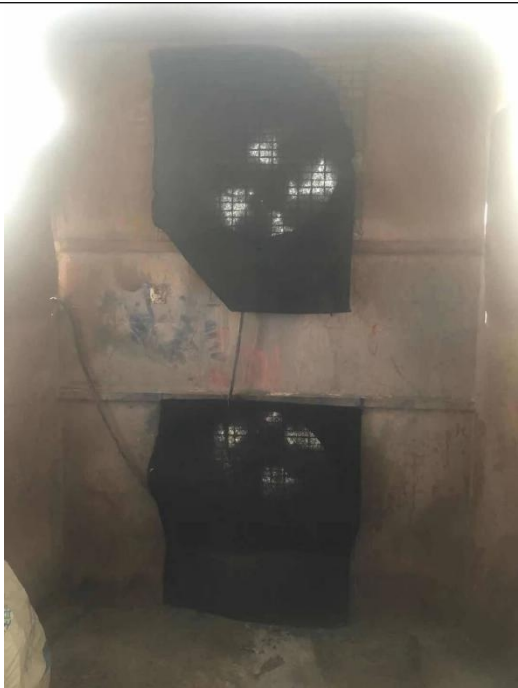
危废间内排风过滤装置
